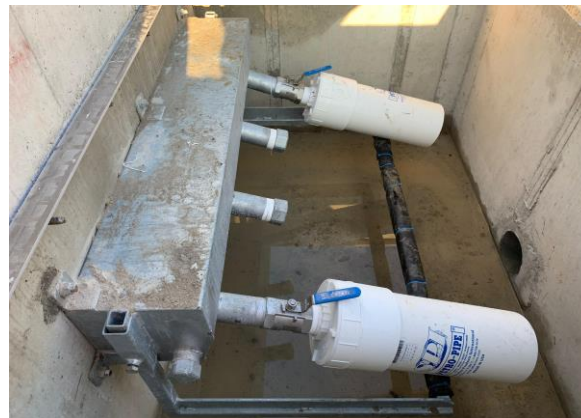
SKID 1x4 PETRO PIPE regard béton connecté à une fosse de rétention de transformateurs - EDF
