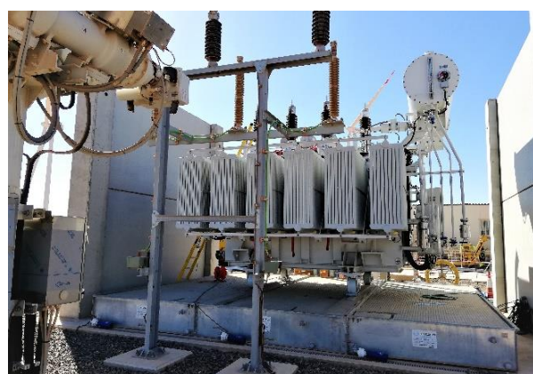
Bac TRT-MODULO 3 équipé d'une couverture coupe-feu EXTICOV LHD avec cartouche de filtration PETRO PIT SPI® - DALKIA
