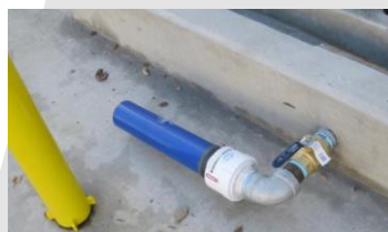
Filtre PETRO PIT 416 monté sur une fosse de rétention en béton
