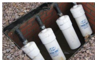
Filtres PETRO PIPE PI-616-M2 montés en parallèle
